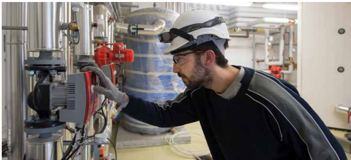
ENGIE accompagne les hôpitaux, dans la durée, sur la performance du patrimoine et la maîtrise des risques
