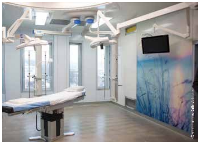
Exemple de réalisation ORigami™, salle d'opérations (Södertälje Hospital, Suède)
