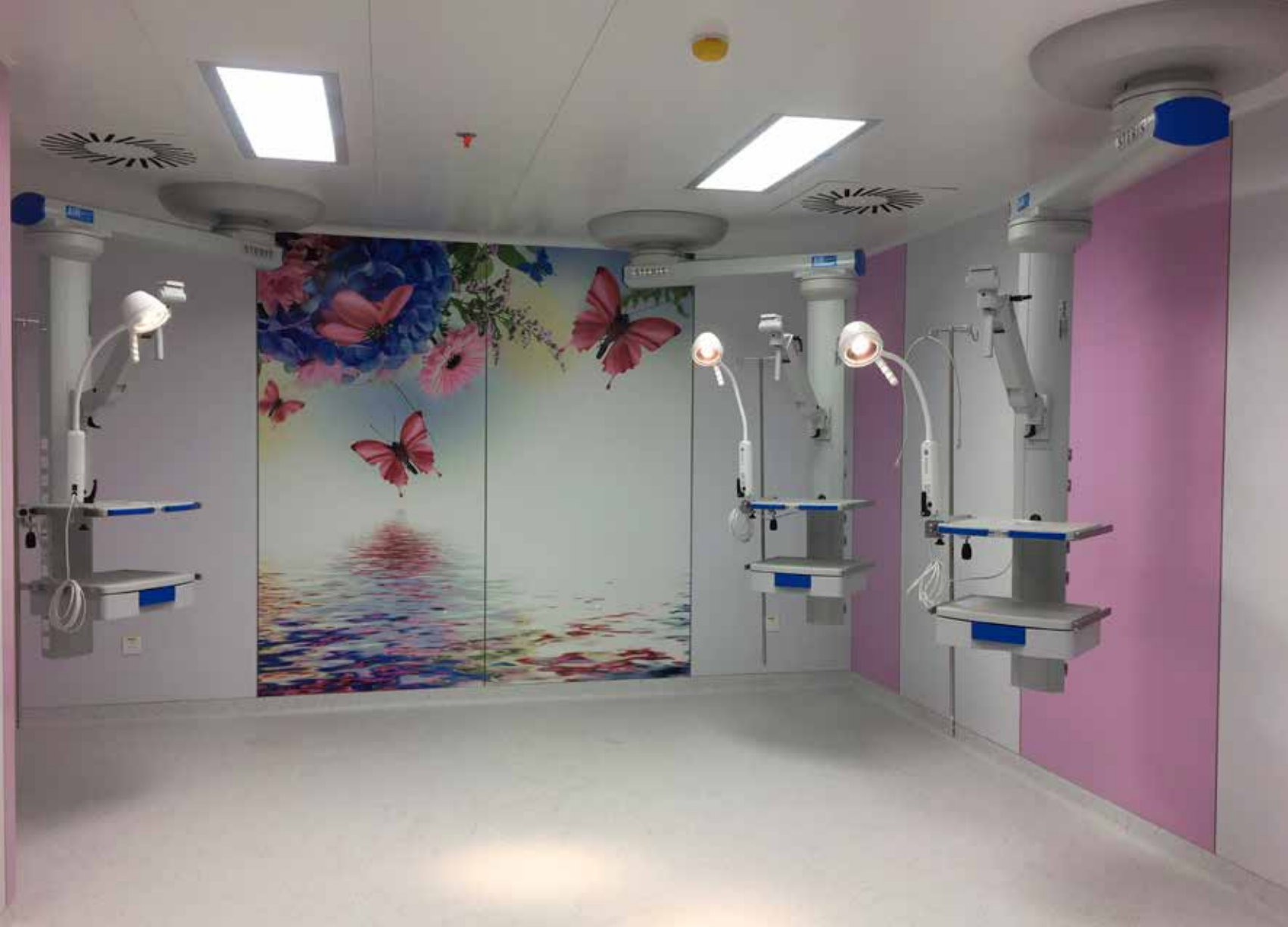
Exemple de réalisation ORigami™, salle de soins intensifs (Qurrayat Hospital, Arabie Saoudite)
