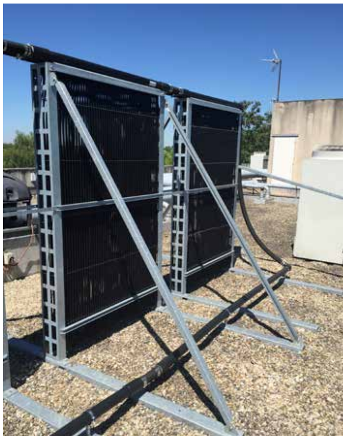
Les mêmes échangeurs FAFCO peuvent être utilisés pour capter la chaleur de l'air et du soleil. Ici sur un hôtel proche de l'aéroport de Roissy - Charles de Gaulle
