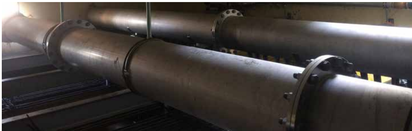
Collecteurs principaux du stockage de glace assurant la charge et la décharge du système. Chaque stockage est constitué de dizaines de kilomètres de tubulures
