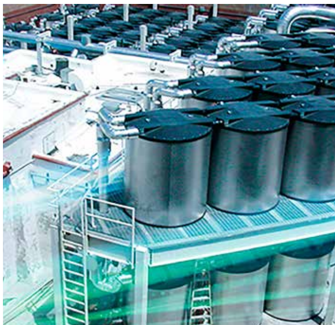
Solutions de stockage de glace intégrées aux systèmes de CVC pour la réduction des coûts d'énergie et d'exploitation
