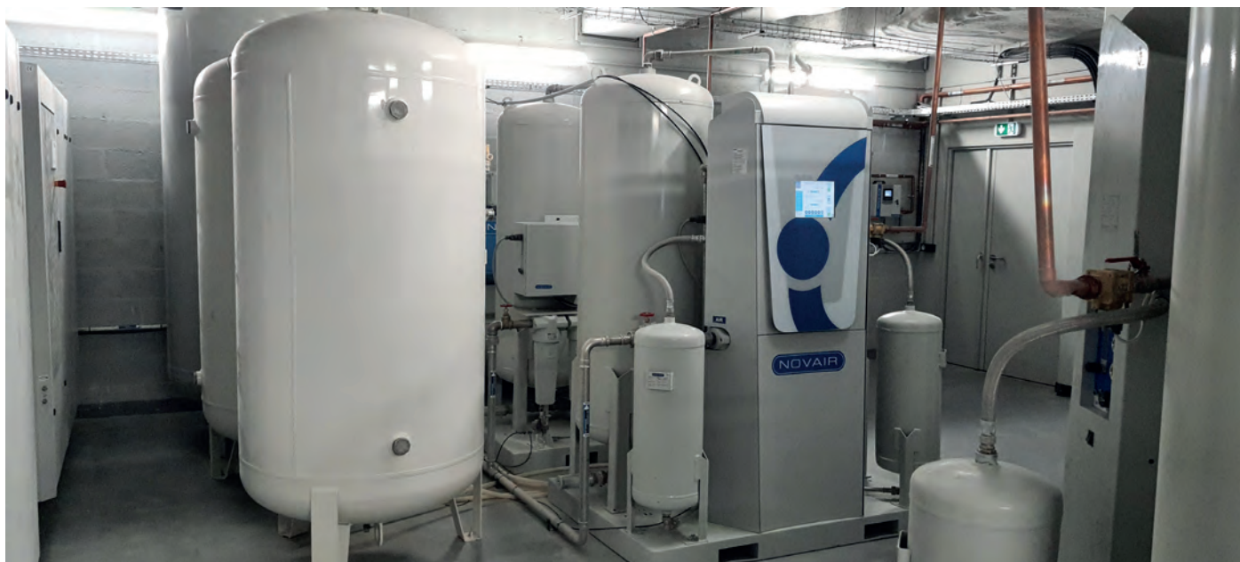
Générateurs très haute pureté (99.5%) en local technique pour l'alimentation en oxygène médical de l'Hôpital Pare Cheres de Neuilly-sur-Seine
