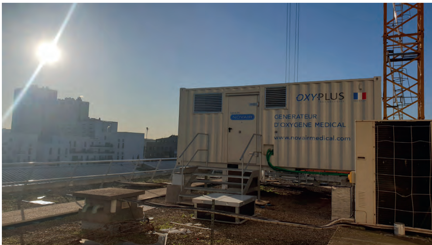
Container équipés de générateurs d'oxygène médical installé sur le toit de l'Hôpital Européen de Paris à Aubervilliers
