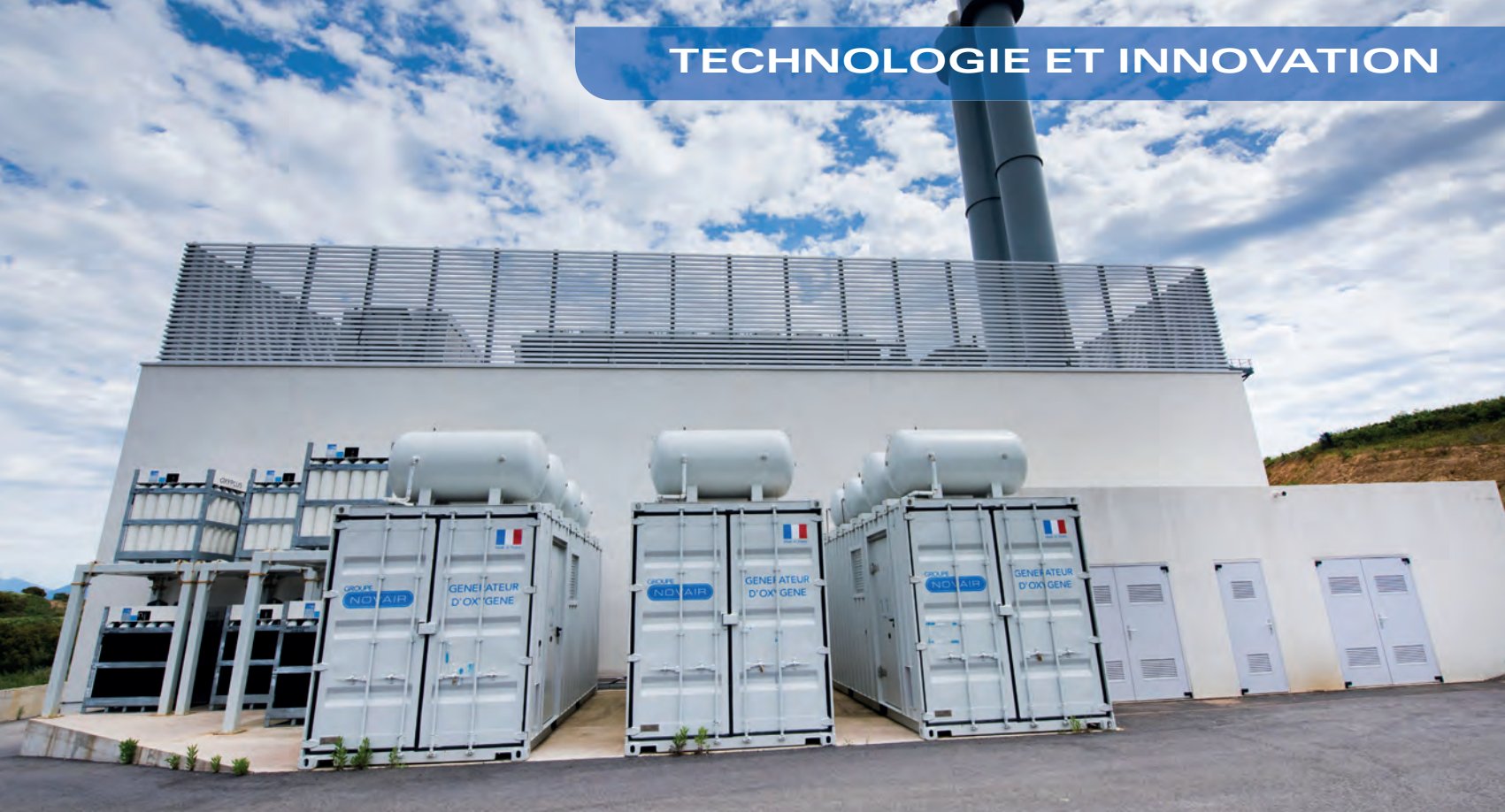
Containers équipés de générateurs d'oxygène médical pour l'alimentation de l'Hôpital d'Ajaccio ouvert en 2023
